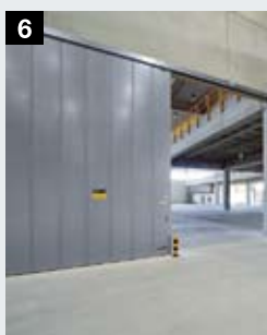
6 Puertas correderas cortafuego
